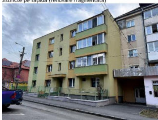
AȘA NU - Placarea acoperirii zonei de acces cu tablă cutată lucioasă; utilizarea vopsitoriilor necorespunzătoare AȘA DA - Închiderea balcoanelor în mod unitar
