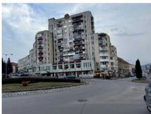
AȘA NU - Fațadă degradată cu balcoane închise în mod neomogen Parter și etaj 1 tratate în mod distinct; Prezența vopsitoriilor distincte pe fațadă (renovare fragmentată)
